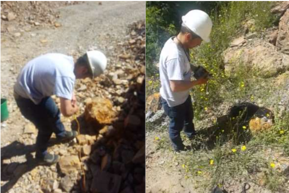
Figura 34: Conexión con Explosor
