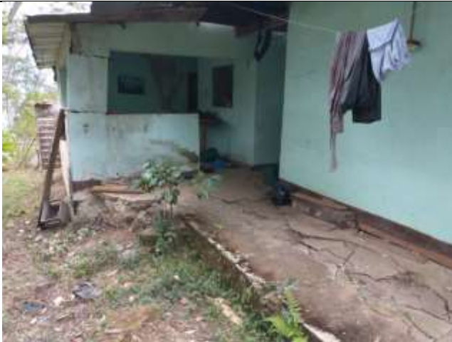
Vivienda afectada vereda Chapacia sector 4 esquinas, fuente: el autor.
