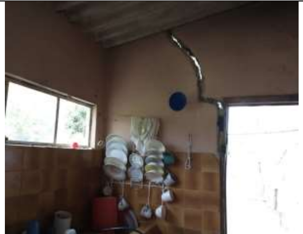
Vivienda afectada vereda de Miraflores sector el Tropezón, fuente: el autor.
