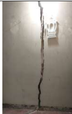
Vivienda afectada vereda de Miraflores sector el Tropezón, fuente: el autor.
