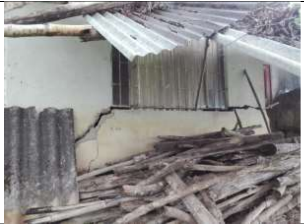
Vivienda afectada vereda de Miraflores sector el Tropezón, fuente: el autor.
