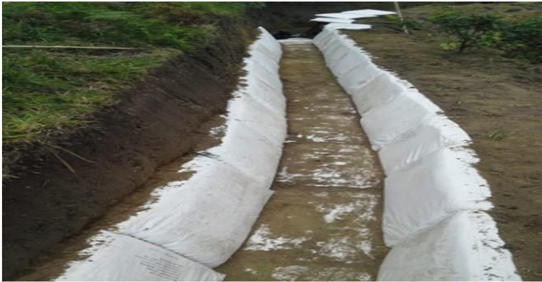
Figura 3. Canales en suelo cemento.
