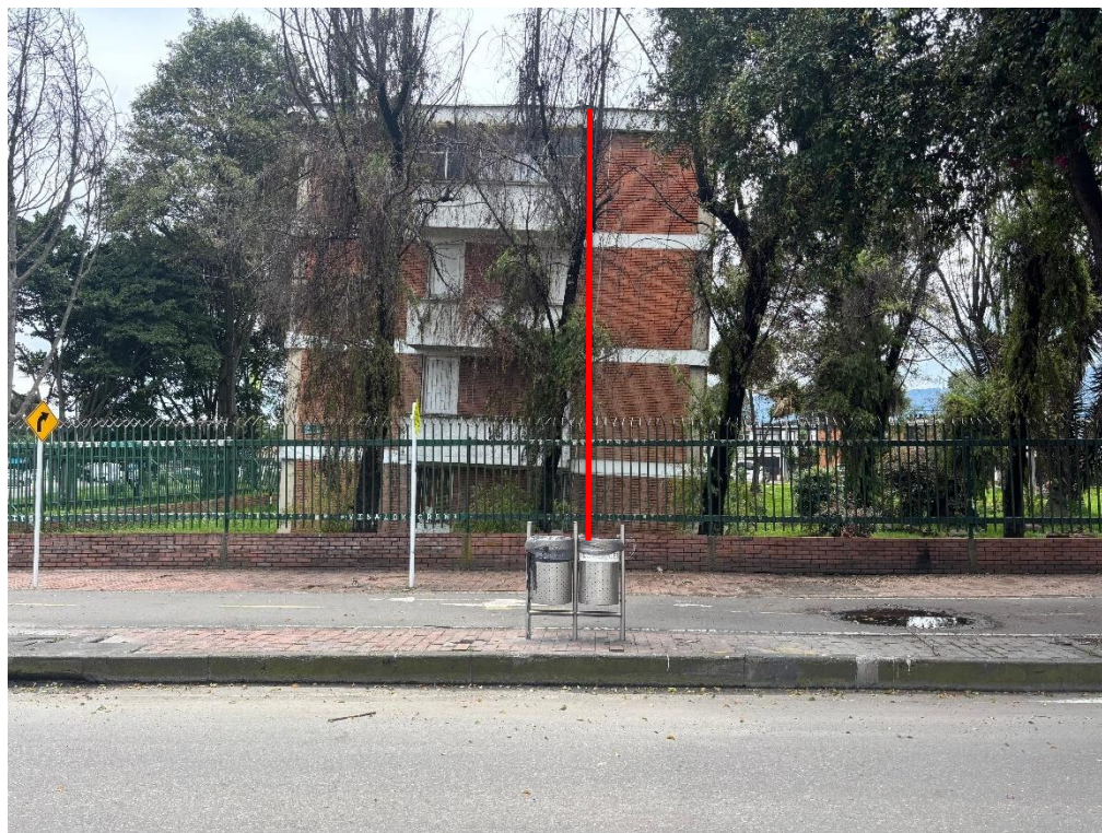
Figura 5: Edificio barrio El Polo, Avenida Calle 80 x Carrera 30. Fotografía tomada el 02/04/2025 en donde se observa el ángulo de inclinación con la vertical debido al asentamiento diferencial.
