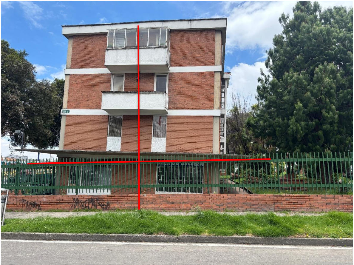
Figura 6: Fotografía tomada en la Carrera 29 con Avenida Calle 80. 02/04/2025. Se observa la inclinación tanto vertical como horizontal producto del cabeceo del edificio hacia la zona interna del conjunto.
