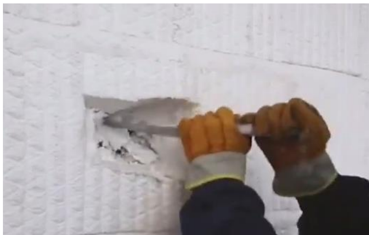
Figura 14. Corte De Cerámica en área de puntos calientes
