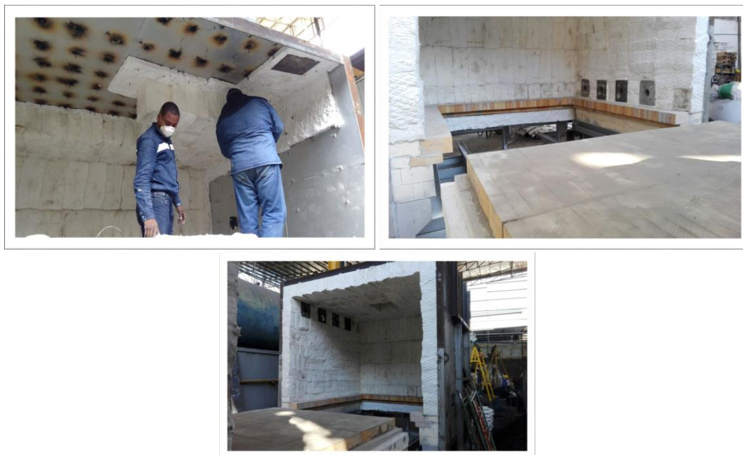
Figura 3. Aislamiento Con Modulos En Fibra Cerámica Romar Ingeniería S.A.S
