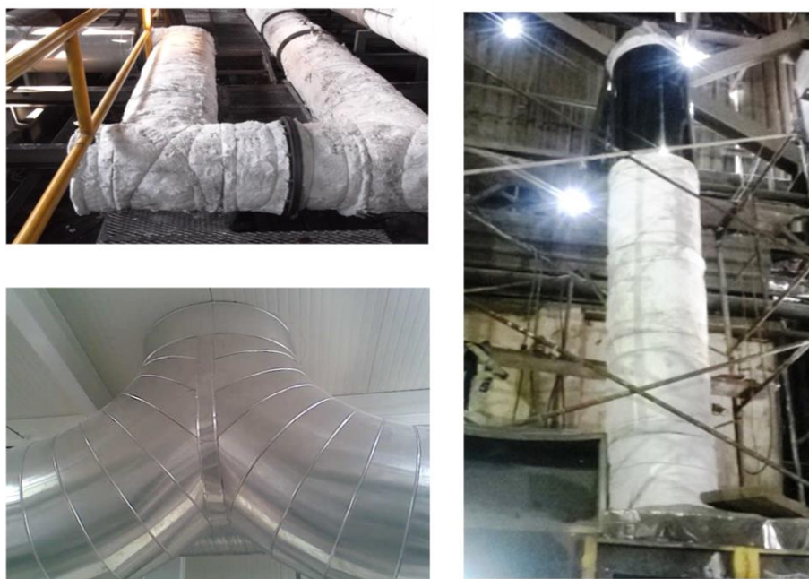
Figura 4. Aislamiento térmico con manta cerámica Romar Ingeniería S.A.S
