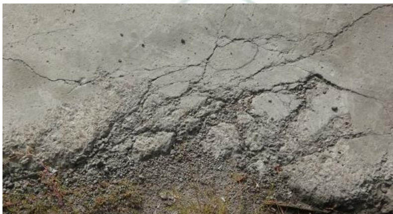
Figura 5.9. Deterioro superficial por pérdida de áridos
