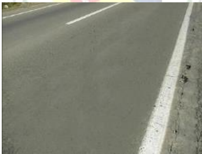
Figura 5.18. Separación entre pavimento y berma
