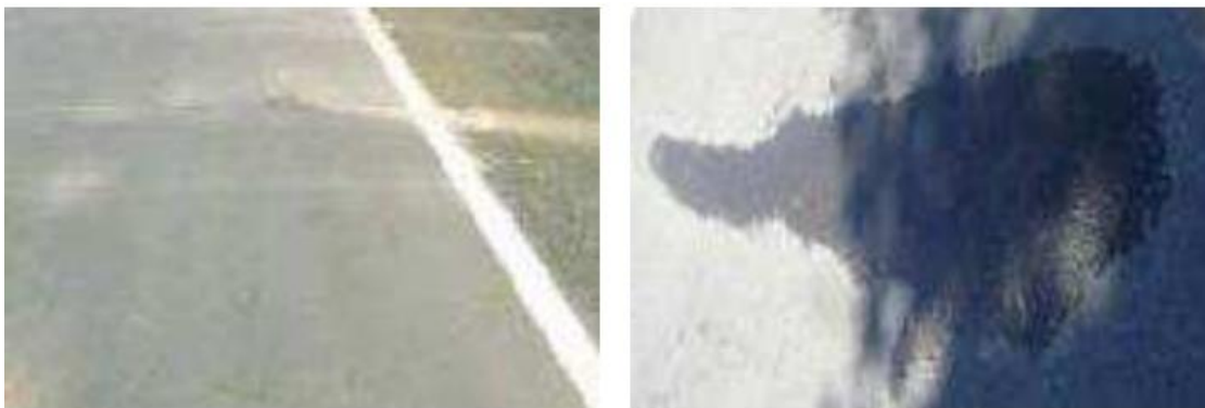
Figura 5.17. Surgimiento de agua y finos
