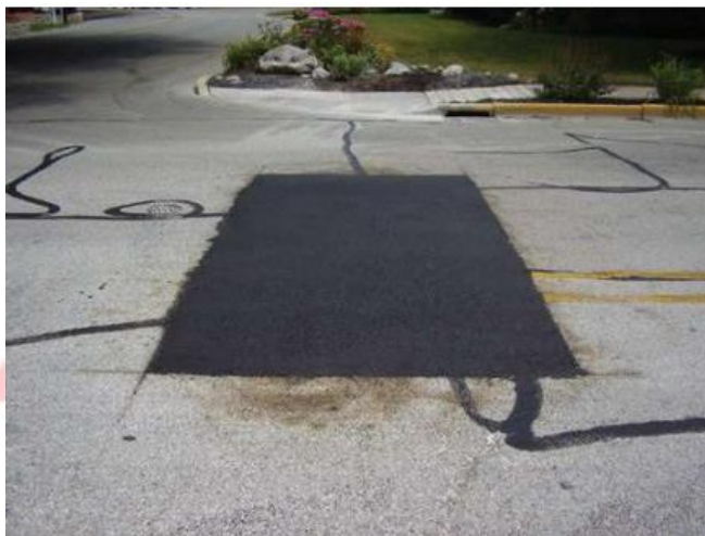
Figura 5.3. Deterioro superficial por parches deteriorados
