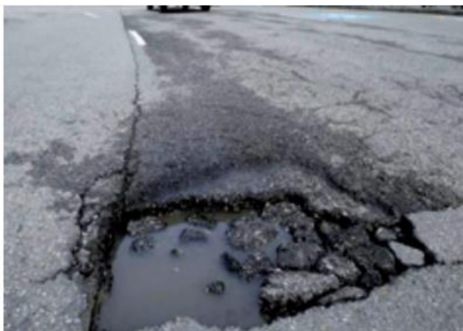
Figura 5.4. Deterioro superficial por baches
