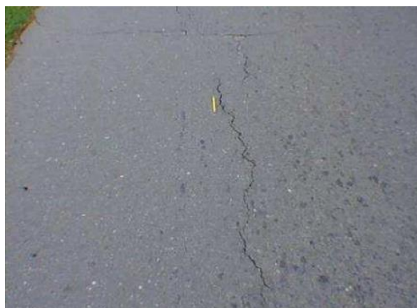
Figura 5.14. Grietas transversales y longitudinales
