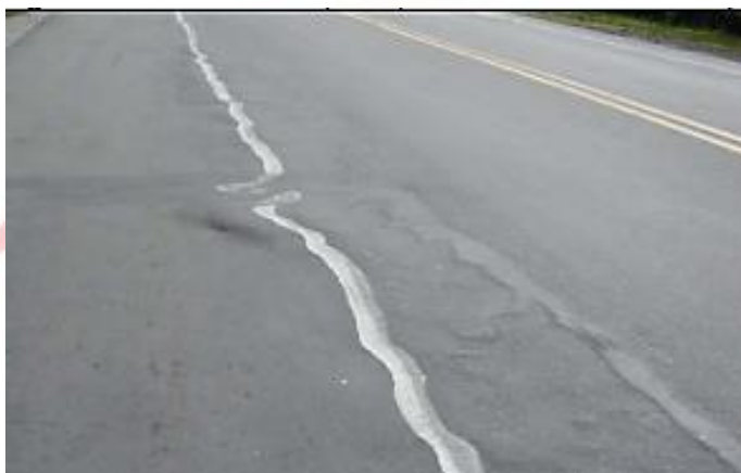
Figura 5.10. Deterioro superficial por ondulaciones
