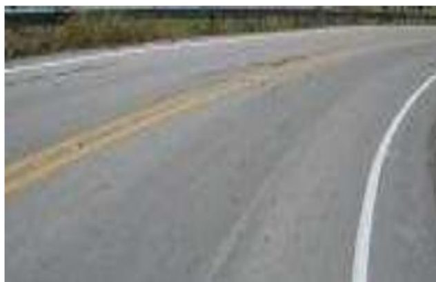
Figura 5.8. Deterioro superficial por desgaste
