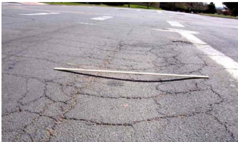
Figura 5.5. Deterioro superficial con ahuellamiento
