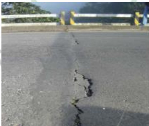
Figura 5.15. Fisuras y grietas reflejadas
