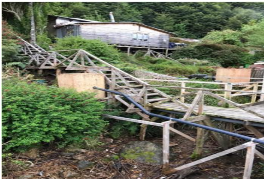
Figura 14. Tuberías y cámaras de vacío instaladas sobre la superficie
