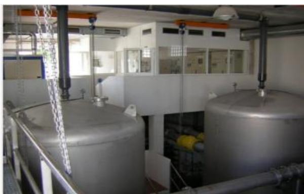
Tanques de vacío
